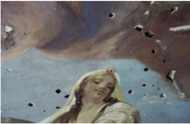
FIG. 48 Pechina del fresco del Misterio de la Encarnación de Luca Giordano, en la que el estuco original que hacía de arriccio estaba completamente degradado
