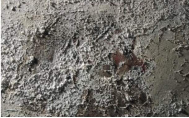
FIG. 40 Daño producido por las criptoflorescencias salinas en la pintura al fresco de las bóvedas de la Basílica
