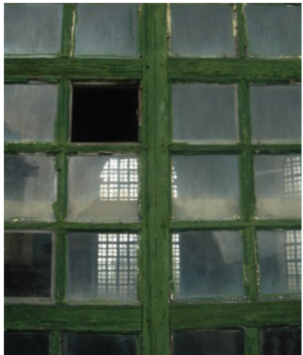
FIG. 32 Estado de la carpintería del tambor con anterioridad a la intervención
